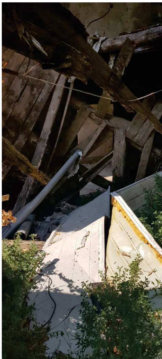
6.04 - Materiale crollato del solaio in legno
