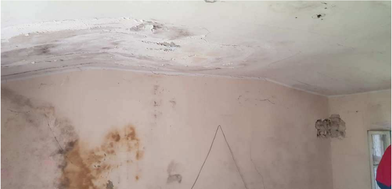
6.19 – controsoffitto in pannellatura di fibre di legno, si evidenziano irregolarità nella forma
