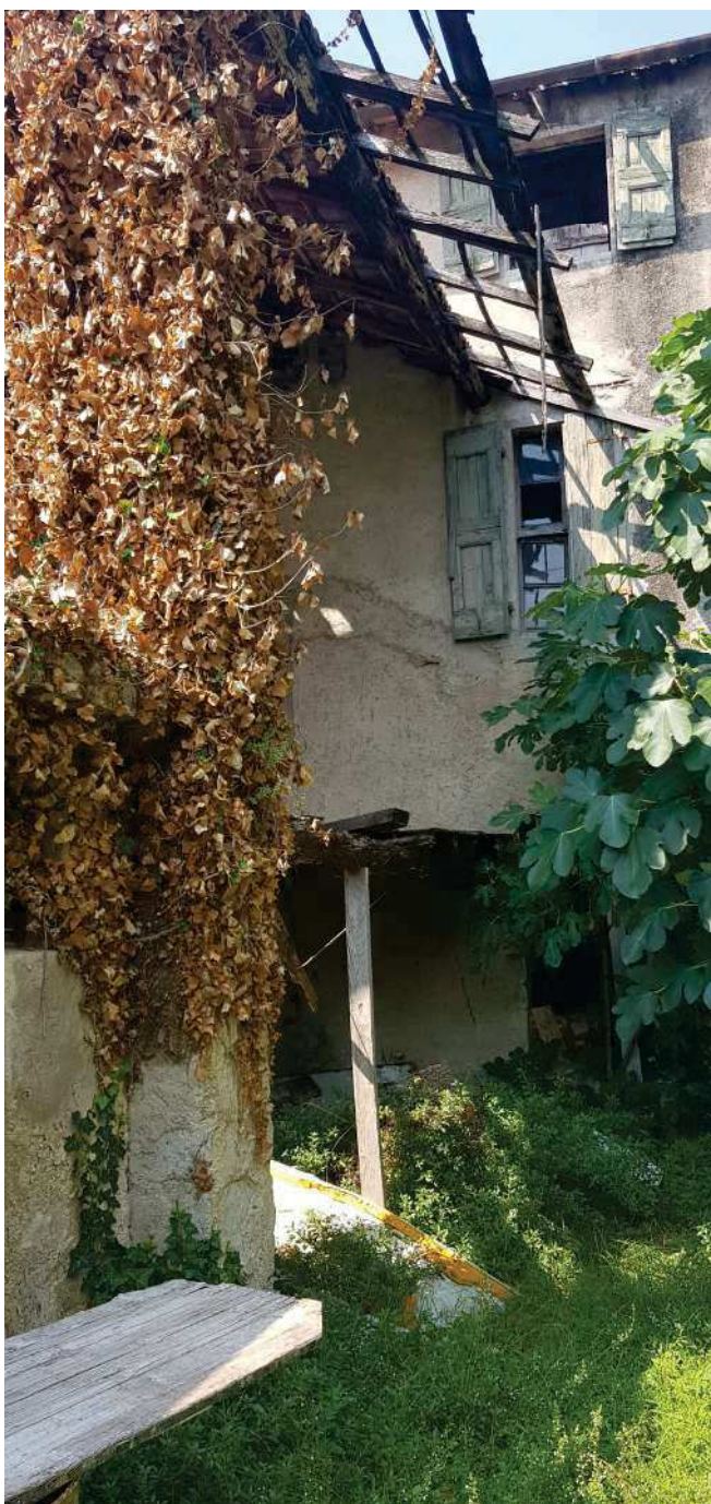
6.03 - Porzione di copertura crollata del porticato
