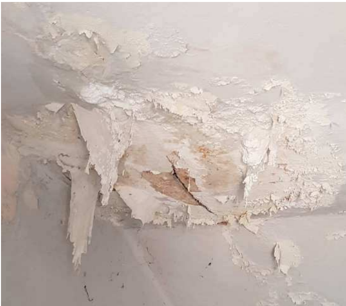
6.18 – Dettaglio del degrado della volta che rende visibile i pannelli in fibra di legno
